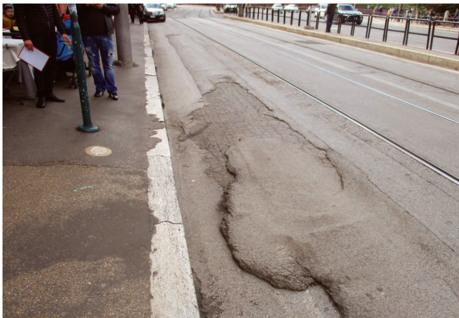
Lo stato di degrado delle nostre strade. Non solo buche: asfalto dissestato
